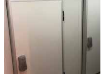
Soğuk Hava Deposu
